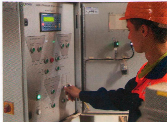
Рис. 5. Пульт управления линией приготовления огнеупорной массы пресса ДАО-242
